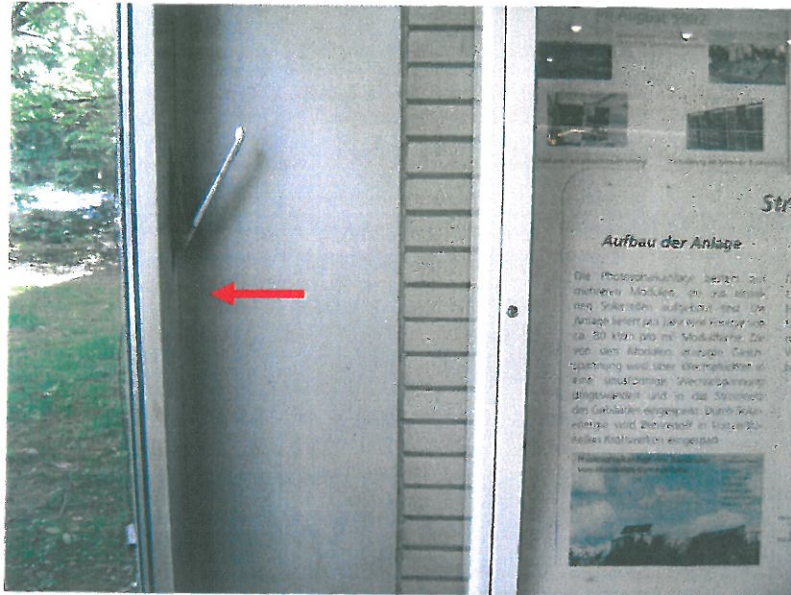
Bild 14: Fugendichtmasse am Fensterfront, Eingangsbereich, EG
