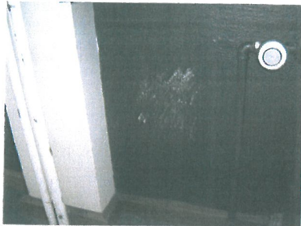
Bild 9: Wandfarbe hinter dem Heizkörper, Raum 126
