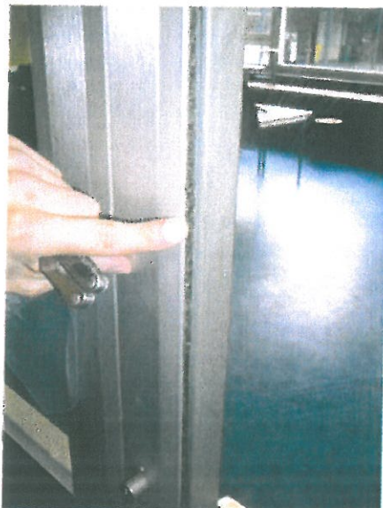
Bild 1: Fensterkitt, Türe zum Aufenthaltsraum 027
