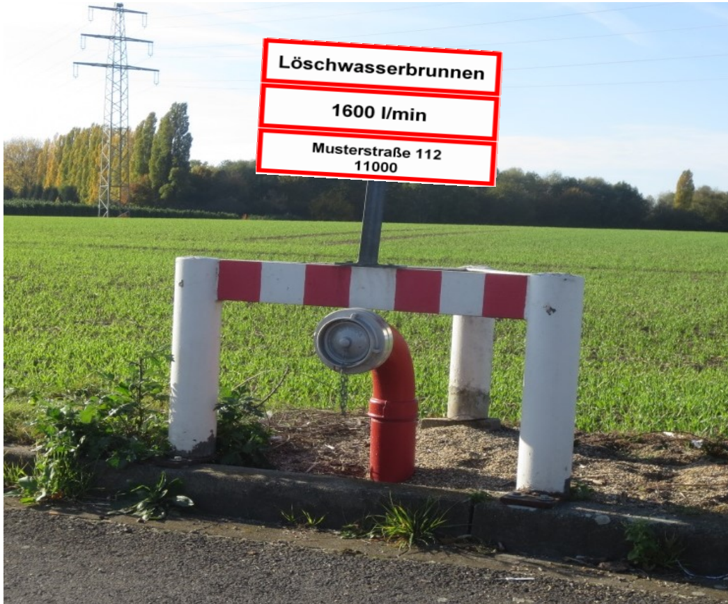
Saugstelle mit Anfahrerschutz
