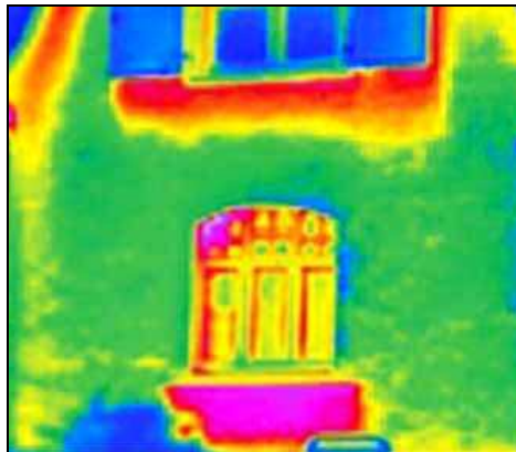
Bild 7.3: Infrarotbild mit Wärmeverlust durch Heizkörpernischen /32/
